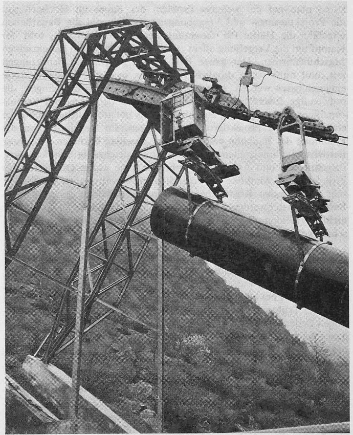
Bild 5. Schwerlastbahn Piano di Peccia. Bauherr: Kraftwerke Maggia SA; Projekt: A. Schönholzer; Ausführung: Habegger, Thun, und Tenconi, Airolo (Photo H. Heiniger, Spiez)
