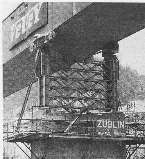
Bild 3. Autobahnbrücke über die Veveyse. Provisorische Pfeileraufbauten mit Rollenbatterien von 800 t Tragkraft (links) und 400 t Tragkraft (rechts)
