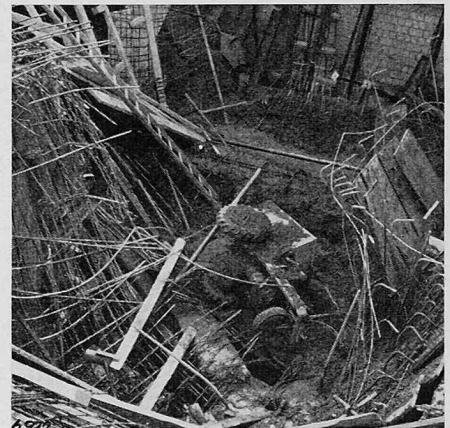
Eingestürztes Deckenfeld. In der Mitte ist der für die Betontransporte benutzte Motorkarren ersichtlich («Herkules»-Kipper)
