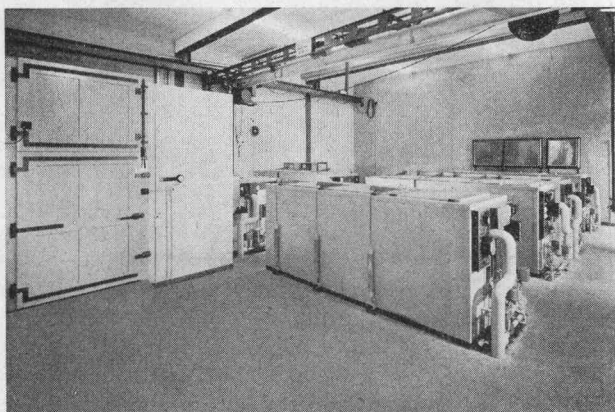
Beton-Frostanlage in der Empa
