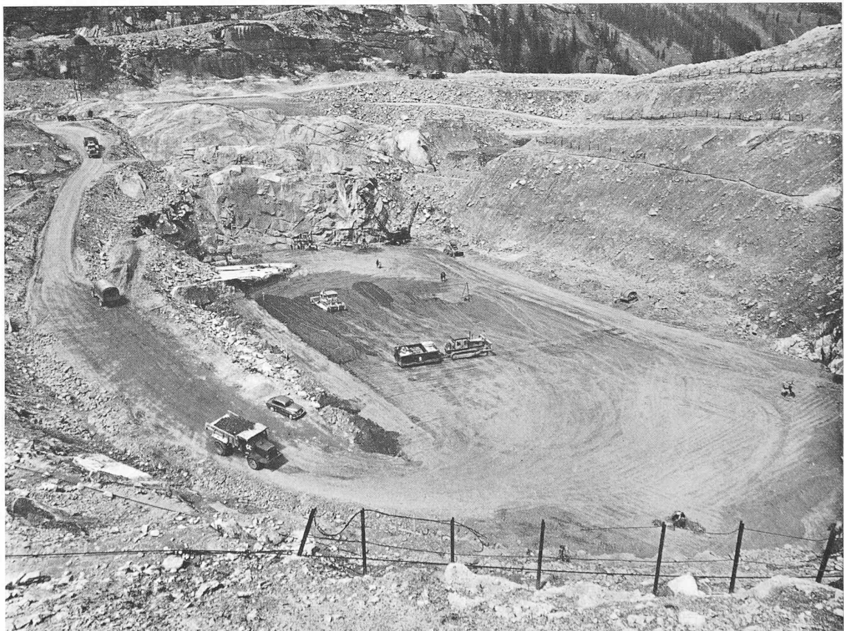
Bild 5. Der Kerneinbau in der bis auf den Fels ausgehobenen Baugrube des Staudammes Göschenentalp
