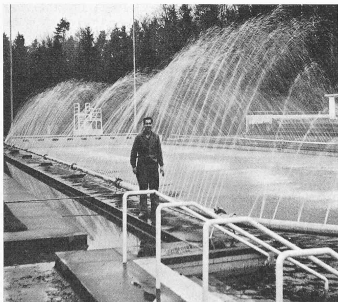
Bild 5. Rückkühlanlage unter Verwendung des bestehenden Schwimmbades
