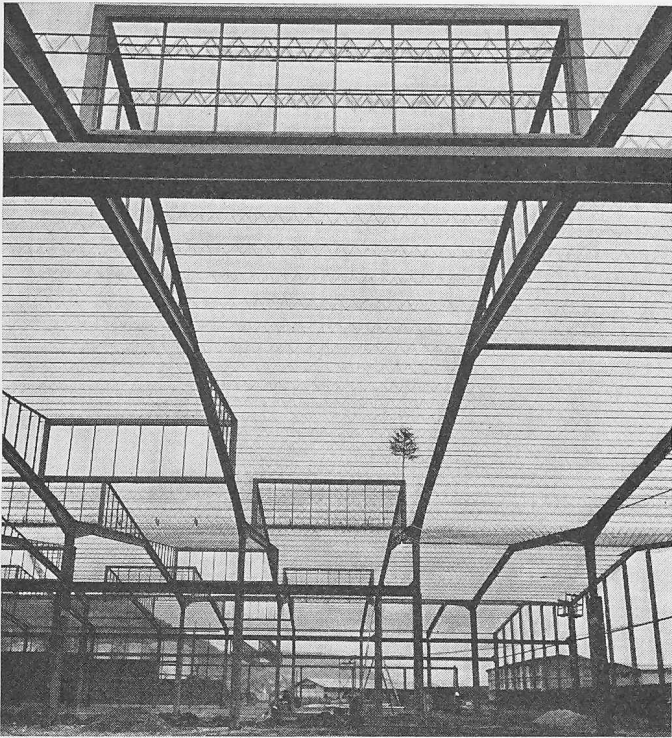
Bild 9. Quer-Durchblick im Montagestadium. Trotz noch fehlender Verspannung sind die nur aus Flacheisen 35 x 10, 40 x 12 und 50 x 12 sowie Rundeisen \phi 10 und 12 mm bestehenden, 9 m weit gespannten Pfetten bereits gut ausgerichtet
