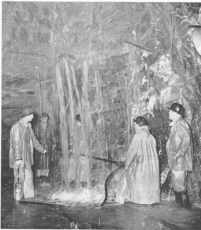
Fig. 3. Galerie Ait Ouarda—Afourer, venues d'eau au PK 2557 de l'attaque A. Photo J. Belin
