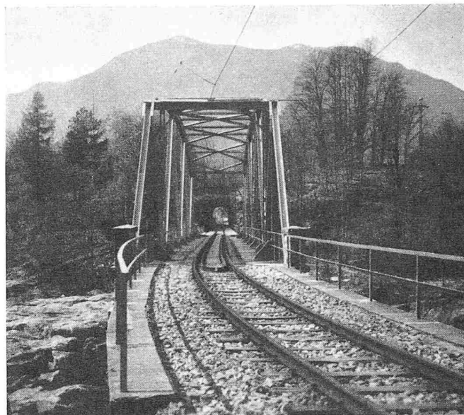
Bild 9. Durchsicht (im Hintergrund, in einiger Entfernung, kleiner Tunnel). Beginn der Kurve des Gleises noch auf der Brücke
