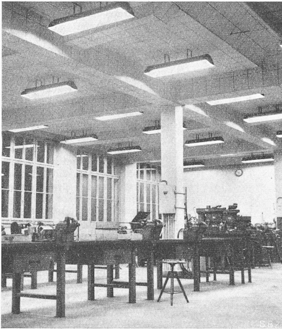
Bild 1. Fabrikbeleuchtung in einer mechanischen Werkstätte mit dreiflämmigen Leuchten für Fluoreszenzlampen TL 40 Watt. Mittlere Beleuchtungsstärke 350 Lux
