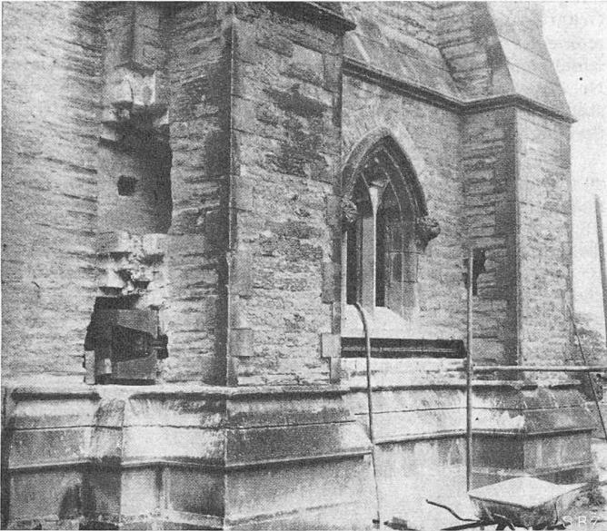
Bild 7. Kirchturmverstärkung. Schlitz und Nische mit eingesetztem Ankerkörper auf der Südseite (vgl. Bild 3, linke Seite), darüber leere Nischen, zur Aufnahme der Ankerkörper vorbereitet, für die Verstärkung der Westwand bzw. Ostwand
