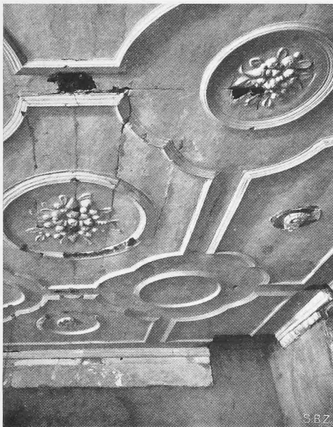
Abb. 15. Stuckdecke vor der Renovation
