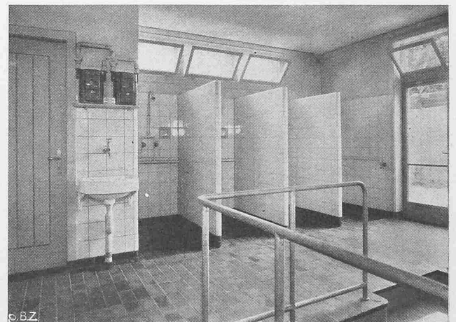
Abb. 6. Douchenraum, links Gas-Warmwasser-Automaten
