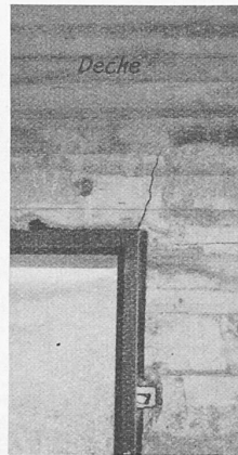
Abb. 11. Riss in einem Türsturz
