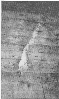
Abb. 9. Riss in Gehweg-Auskrägung einer Eisenbetonbalkenbrücke mit Sinterbildung
