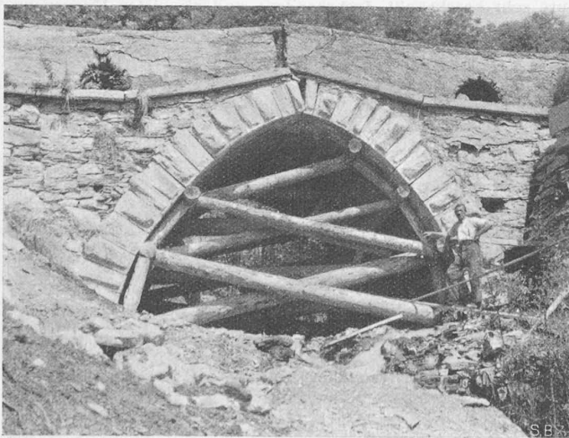
Abb. 4. Durch einseitigen Schub zerstörte Brücke im Val Gronda
