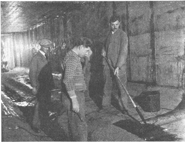
Interessante Isolierung eines Sole-Behälters
