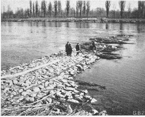
Abb. 4. Bühne im Bau bei franz. Km. 53,429 bei Niederwasser, Q = 456 \text{ m}^3/\text{sec} (18. Febr. 1932).
