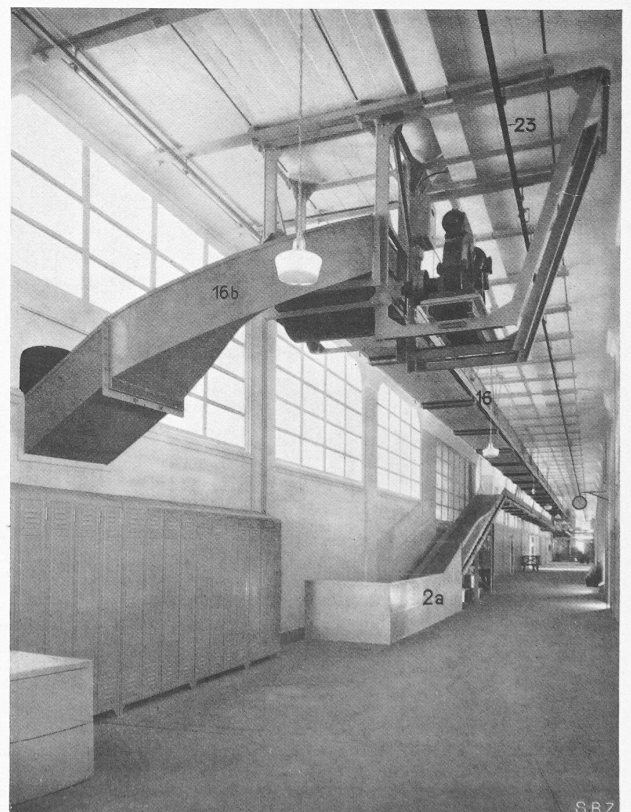
Abb. 27. Förderbänder und Hängebahn im Gang des Erdgeschosses.
