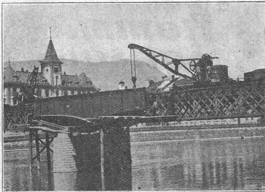
Zwei Drehkrane auf Drehstellwagen mit Wippauslegern, Tragkraft je 15 Tonnen, beim Einbau von Brückenträgern.
