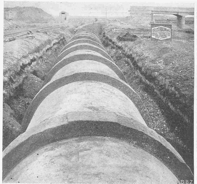
Abb. 22. Leitung der „Mittlern Isaar A.-G.“, d bis 2,0 m, pi 1,7 bis 2,4 at.
