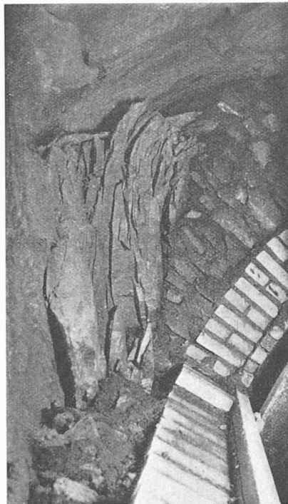
Abb. 3. Bergschläge bei Km. 9,672 ab N.-P. Abb. 1 bis 3 im Simplon-Tunnel II.
