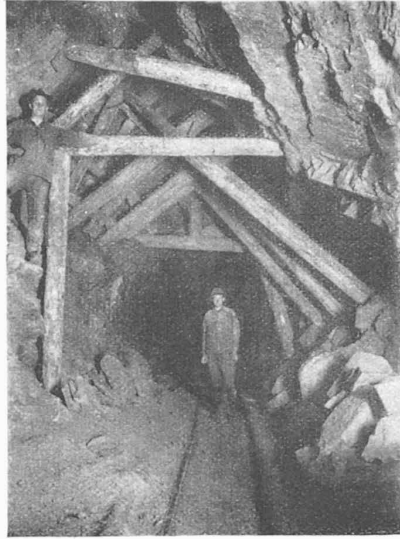
Abb. 34. Niederbrüche bei Fenster 6 (20. VII. 21).
