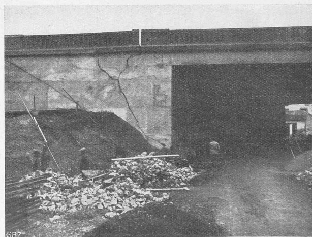
Abb. 1. Setzung der Flügelmauern bei einer Wegunterführung. Zum Artikel „Bauerfahrungen im Moor“.
