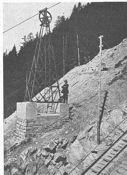
Abb. 31. Stützrolle der Seilrückführung.
