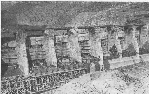
Abb. 18. Stauklappen in horizontaler Lage in Montage begriffen, im Schutze hölzerner Abschlusswände in der Dammbalken-Ebene. Klappen Nr. 4 bis 7 bereits bis an die Drehkante eingeschoben.
