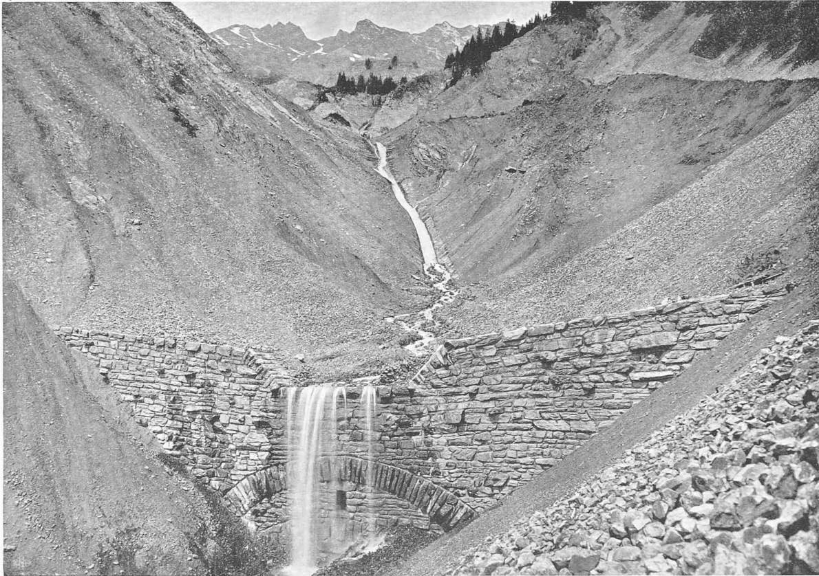
Aus: Wildbachverbauungen und Flusskorrekturen in der Schweiz. Herausgegeben vom Eidg. Oberbauinspektorat (Text siehe Seite 29).
