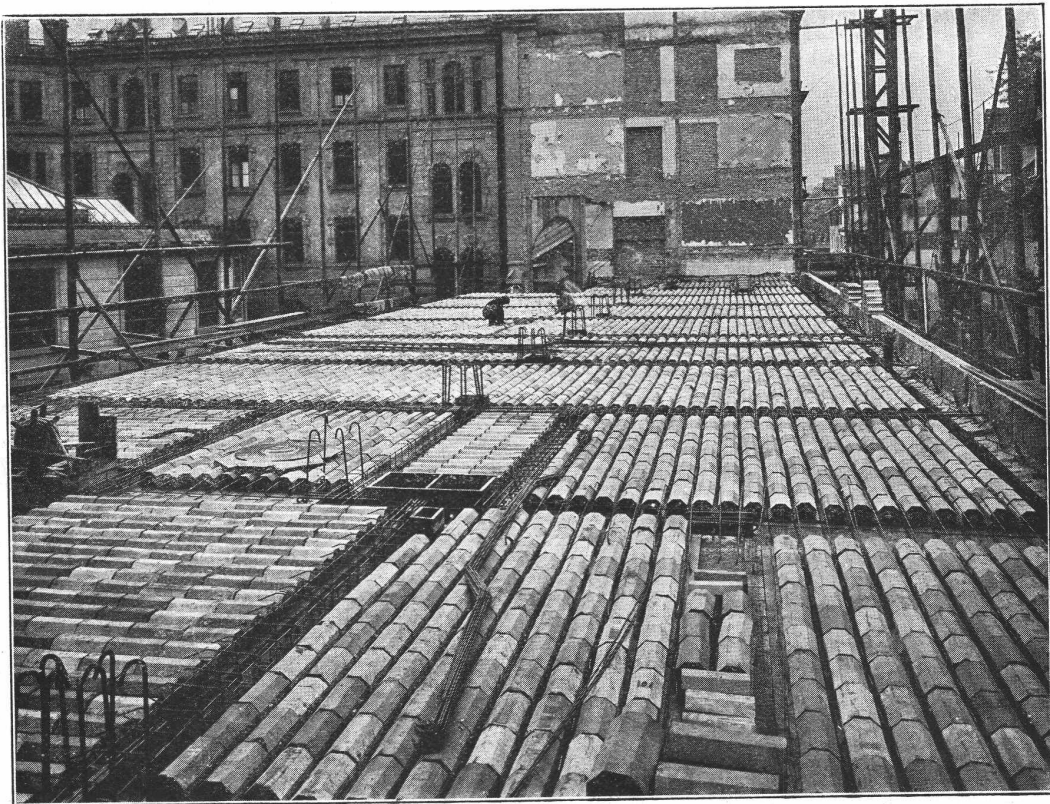
Neubau Kreditanstalt Zürich. Decke über Parterre. Ausgeführt durch: Baugeschäft Locher & Co., Zürich. Bauleitung: Gebrüder Pfister, Architekten, Zürich.
