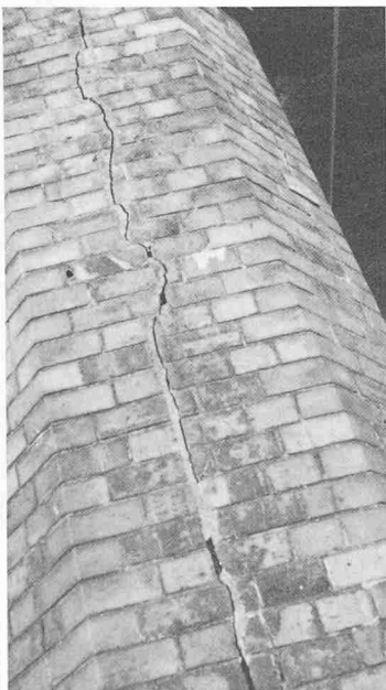
Links: Riss in einem Pfeiler einer Strassenbrücke
