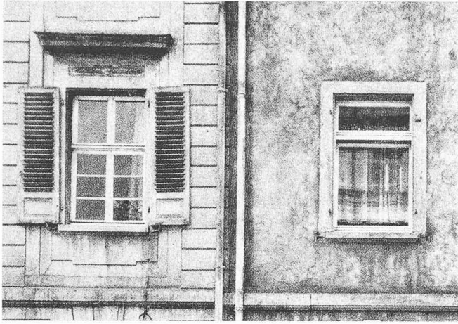
Zwei ursprünglich gleiche Fenster an nebeneinanderliegenden Häusern: Es ist erstaunlich, wieviel eine gefühllose Erneuerung zerstören kann
