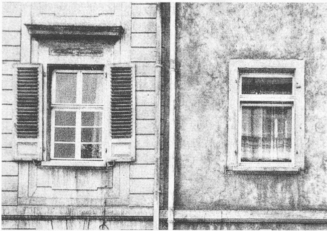
Zwei ursprünglich gleiche Fenster an nebeneinanderliegenden Häusern: Es ist erstaunlich, wieviel eine gefühllose Erneuerung zerstören kann
