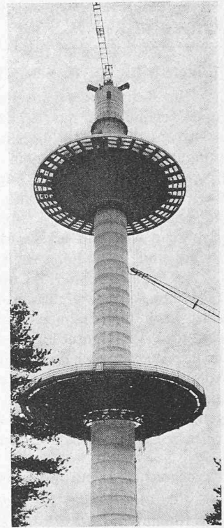
Bild 3 (rechts). Fernmeldeturm Wesendorf (FMT 14; 1970/71) während des Baus; 94 m hoher Schaft aus Kletterschalungs-beton mit einer Kanzel und drei Plattformen.
