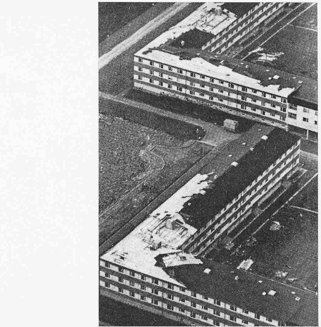
Bild 11. Typische Schäden, Anströmung über die linke Hausecke
