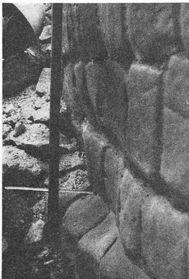
Bild 18. Schäden an der Wehrverkleidung der Fassung am Rio Pativilca nach der ersten Regenperiode. Die zwei unteren Blockreihen wurden gegen 20 cm abgeschliffen
