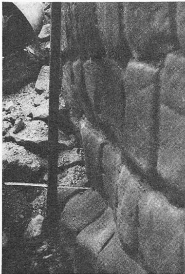
Bild 18. Schäden an der Wehrverkleidung der Fassung am Rio Pativilca nach der ersten Regenperiode. Die zwei unteren Blockreihen wurden gegen 20 cm abgeschliffen
