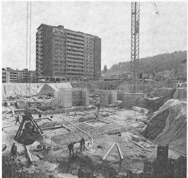
Die Baustelle Ende Mai 1971. Fundationsarbeiten im 2. UG und aufgehendes Betonmauerwerk der Installationskerne
