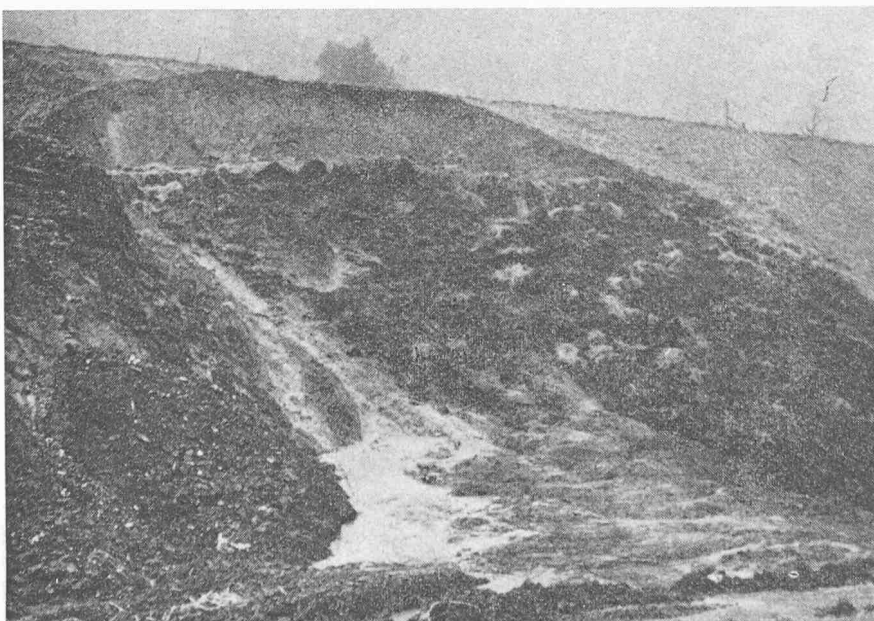
Bild 3. Einschnittsböschung, Abrutsch und Ausschwemmung.
