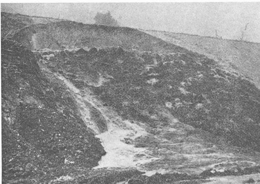
Bild 3. Einschnittsböschung, Abrutsch und Ausschwemmung.
