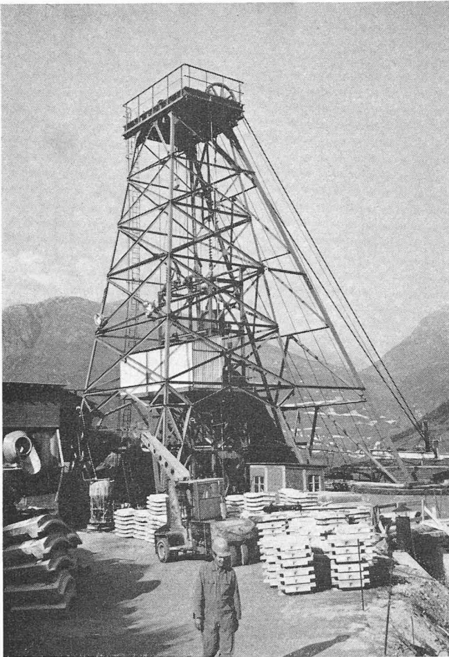
Bild 6. Lüftungsschacht Hospental, Bereitstellen der Fertigelemente für die Schachtauskleidung in der Nähe des Bohr- und Förderturmes
