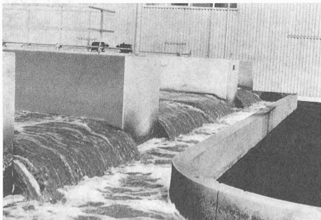
Bild 2. Verschmutzung der Anstriche durch Abwasser in der Kläranlage «Müra»
