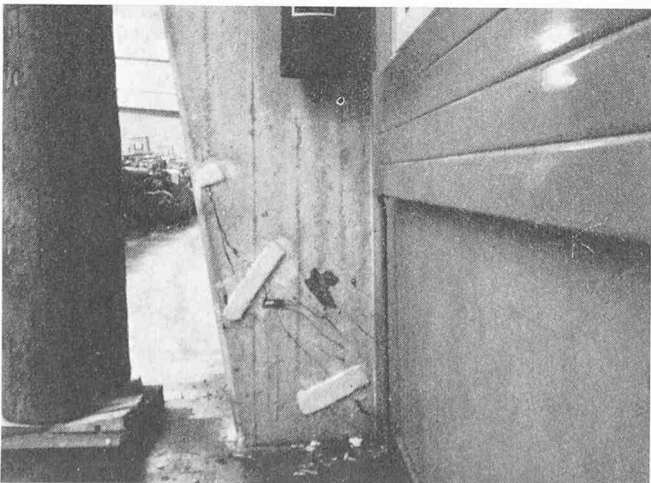
Bild 1. Infolge aussergewöhnlicher Schneemengen geborstener Stützenfuss
