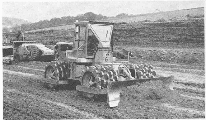
Bild 1. Einsatz des Cat-Verdichters 815 auf der N 12. Mit dem Schaufelblatt kann der Verdichter das Schüttmaterial selbst verteilen und ausgleichen
