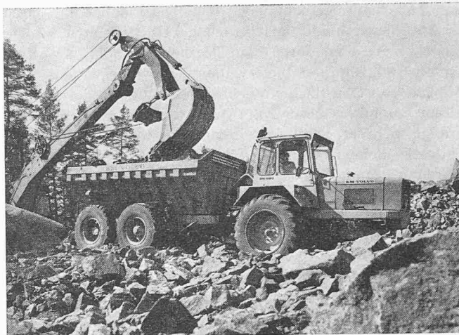
Bild 4. Muldenkipper Typ DR 860 im Einsatz. Leergewicht 12,3 t, Muldeninhalt 10,5 m 3 , Motorleistung 110 PS bei 2400 U/min
