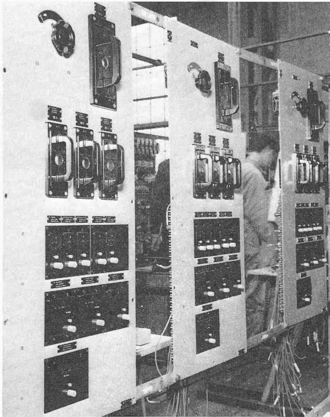
Bild 38. Montage der Schalttafeln C für die Wechselstrom-Hilfsbetriebe im Lieferwerk. Sichtbar sind drei Tafeln für drei Lokomotiven
