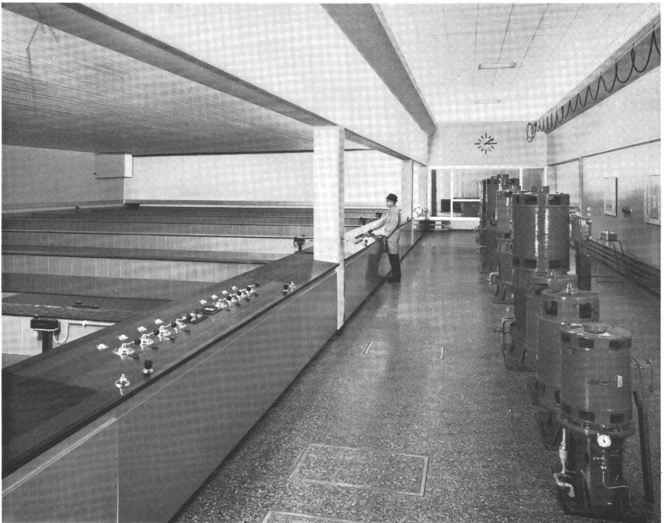
Schnellfilteranlage «Champ-Bougin» der Stadt Neuenburg mit einer stündlichen Leistung von 1800 m 3 . Rechts die Antriebsmotoren für die Pumpen
