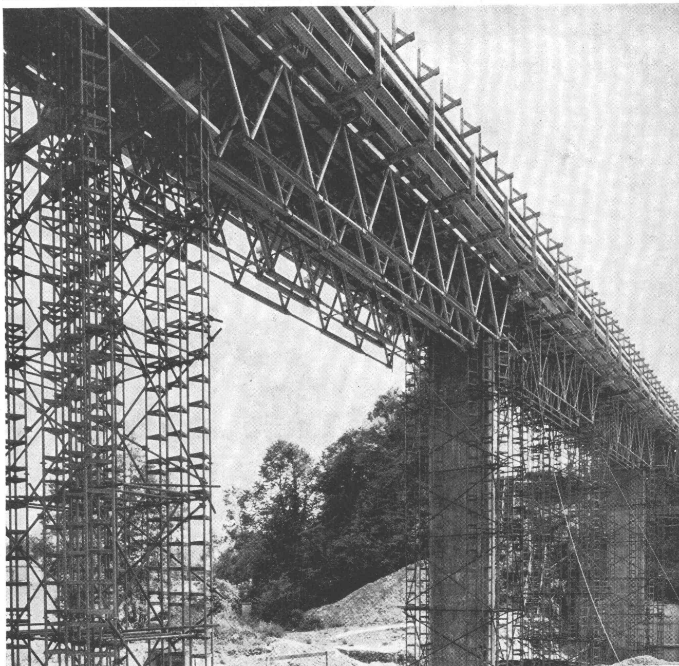
Kaistenbachbrücke bei Laufenburg AG, Länge 154 m, Lehrgerüst ausgeführt für die Arbeitsgemeinschaft Ad. Schäfer + Cie. AG, Aarau/AG Conrad Zschokke, Zürich
