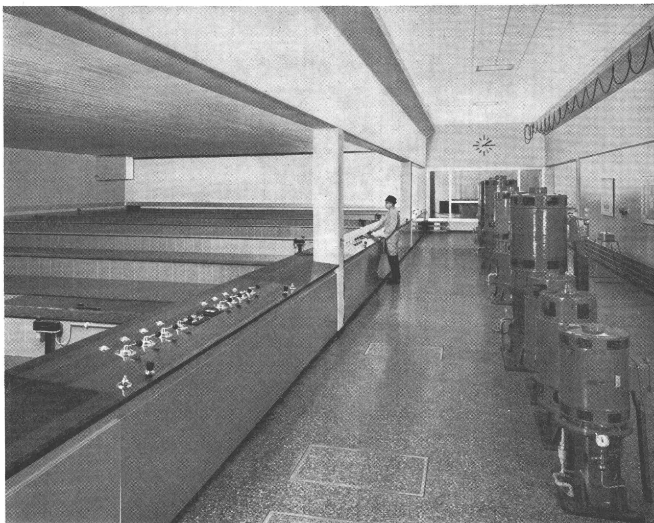
Schnellfilteranlage «Champ-Bougin» der Stadt Neuenburg mit einer stündlichen Leistung von 1800 m 3 . Rechts die Antriebsmotoren für die Pumpen
