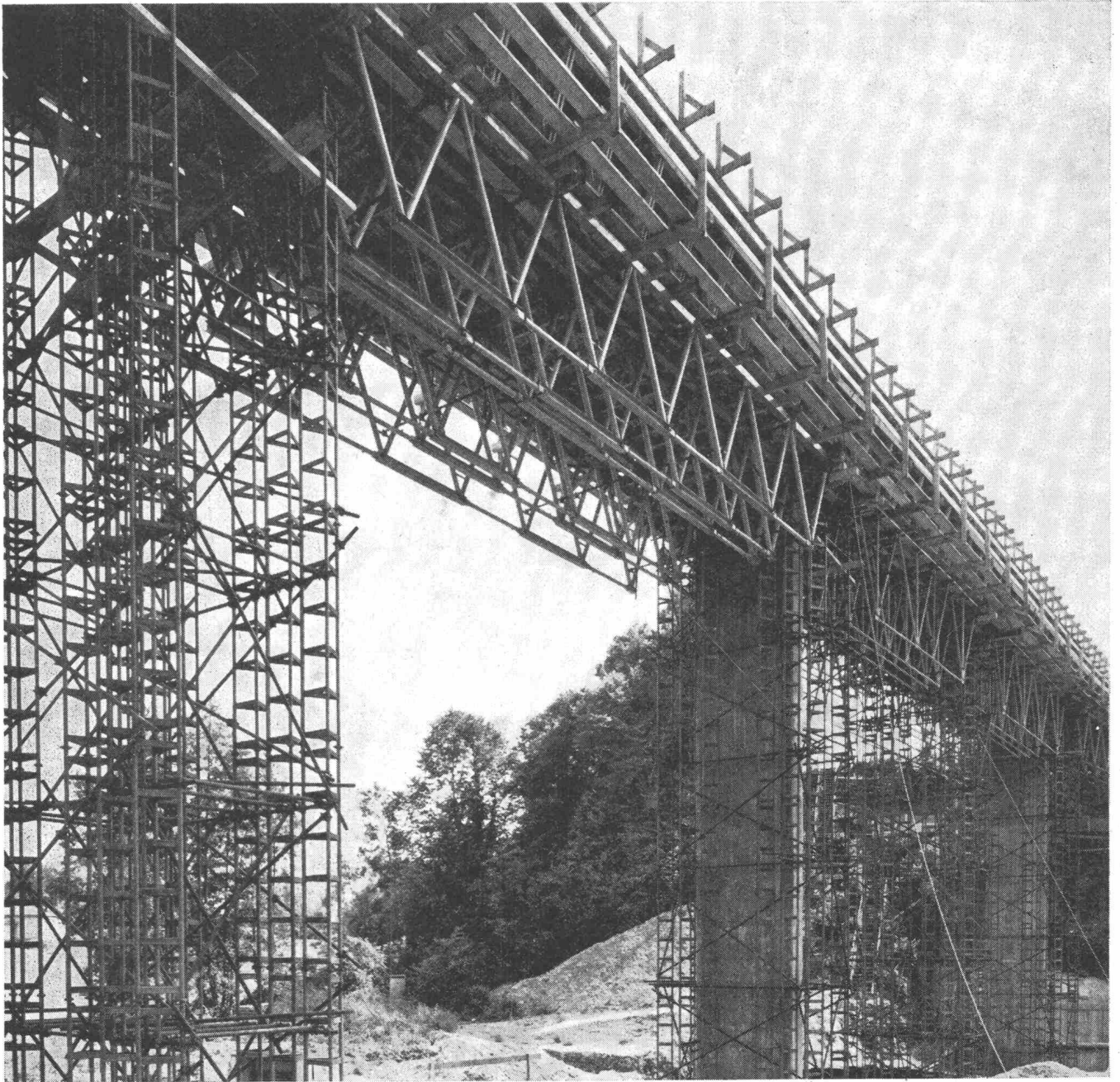
Kaistenbachbrücke bei Laufenburg AG, Länge 154 m, Lehrgerüst ausgeführt für die Arbeitsgemeinschaft Ad. Schäfer + Cie. AG, Aarau/AG Conrad Zschokke, Zürich
