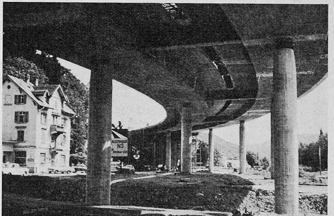
Bild 30. Brückenuntersicht der Etappe 1. Die provisorische Trennung in Brückenaxe zwischen den Querträgern ist noch sichtbar. Das Lehrgerüst für die Etappe 2b ist erstellt
