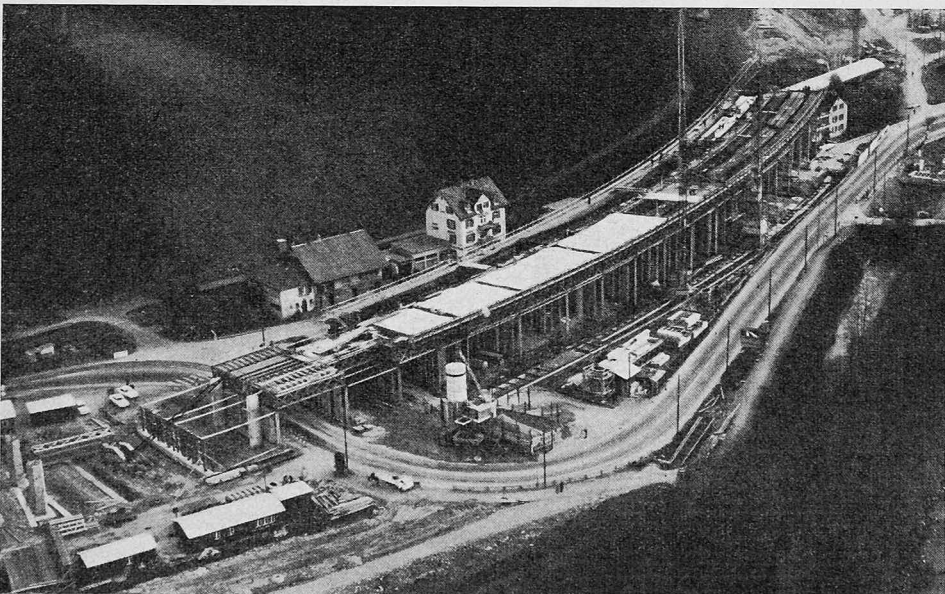
Bild 26. Flugaufnahme der Bauetappe 1. Beginn der Betonierarbeiten auf der rechten Brückenhälfte, November 1964 (Photo Swissair)
