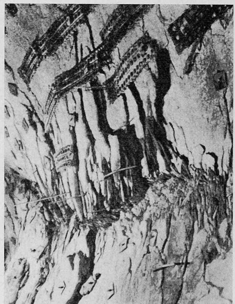
Bild 33. Bruchbildung und Verankerung bei der Druckentlastung im Montblanc-Tunnel. Man beachte das scharfe Auskeilen der abgelösten Gesteinsplatten infolge Scherbruch (vgl. Bild 32) [23, 24]
