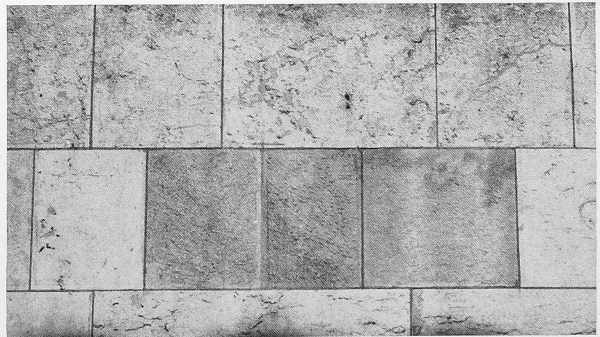
Bild 6. Rostbraun verfärbte pyritreiche Marmorplatten an einer Fassade aus hellgrauen Kalksteinen
