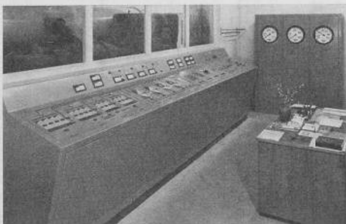
Bild 20 Kommandoraum zur zentralen Steuerung und Überwachung aller heiz- und lufttechnischen Anlagen im Hochhaus
