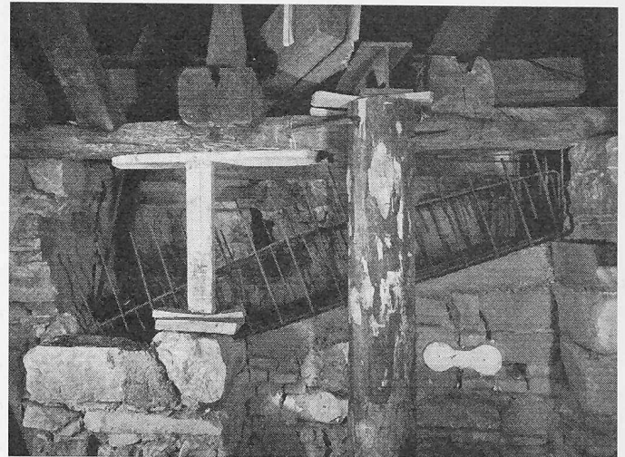
Bild 8. Scheitelknick des Kabels VII. Man sieht den schlechten Zustand des Bruchsteinmauerwerkes und die Gipsiegel zur Beobachtung der Risse
