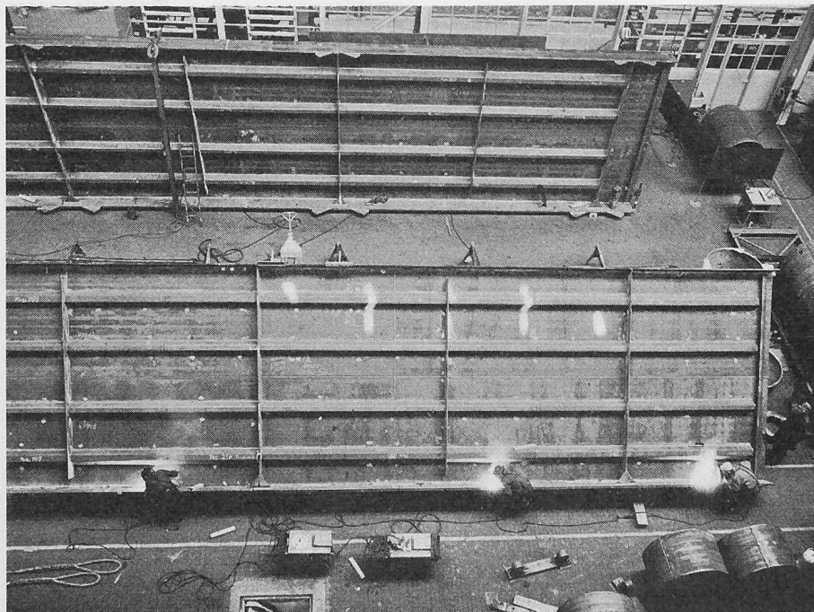
Bild 12. Schweissarbeiten in der Werkstatt. Im Hintergrund ein fertiges Element mit den Knotenblechen für den Anschluss der Windverbandstäbe
